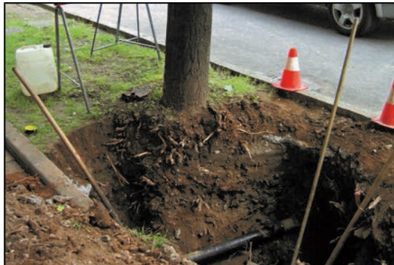
Problemi di cantiere
